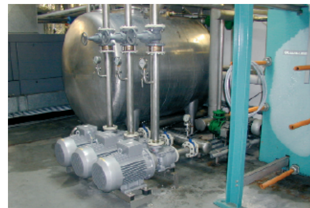
Drehzahlgeregelte Pumpen in einer zentralen Wasserversorgung
