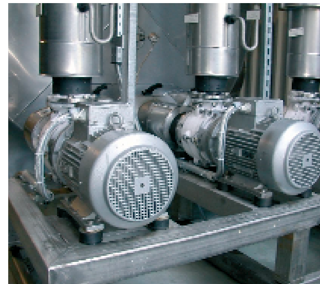
Tieftemperaturpumpen in einer Kälteanlage
