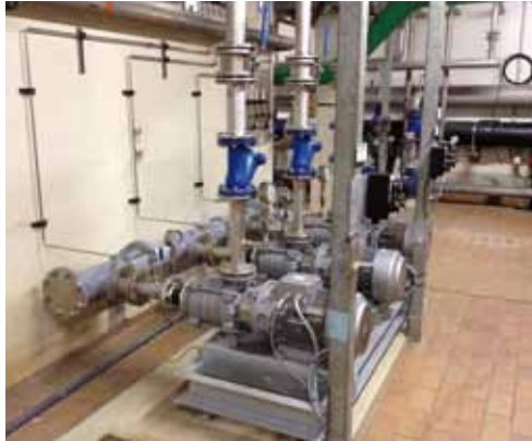
Installierte Edur-Mehrphasenpumpen LBU 603 D160L /15,0 KW
