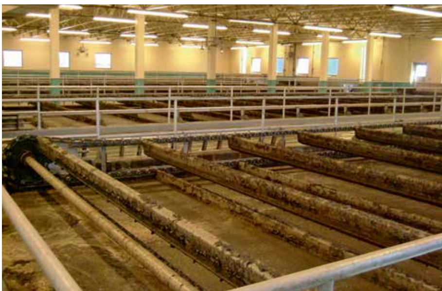
Auch die kommunale Kläranlage in Columbia im US-Bundesstaat Ohio wurde mit den Mehrphasenpumpen von Edur ausgestattet.
