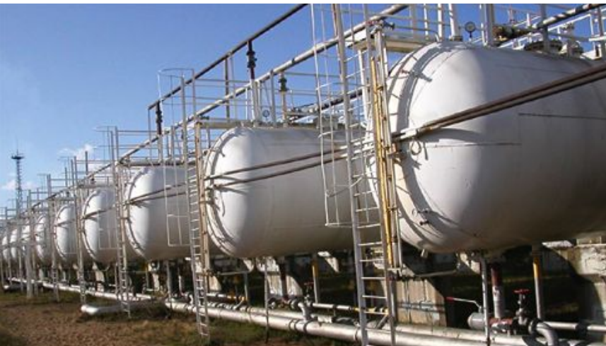
Abb. 3: Flüssiggastanks mit je 175 m 3 Füllmenge in Olaine (Lettland). Hier werden Flüssiggaspumpen eingesetzt.
